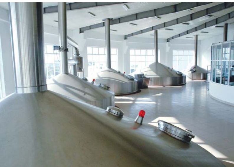
Hệ thống nhà nấu
