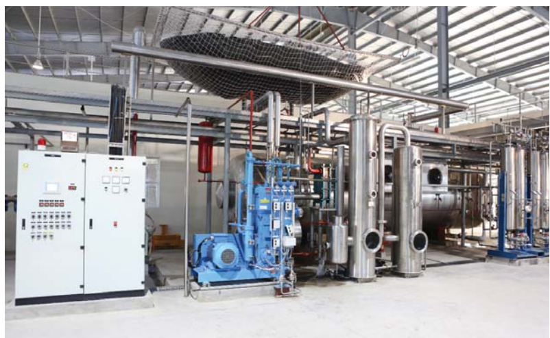
Hệ thống thu hồi CO 2 Nhà máy Bia Sài Gòn - Vĩnh Long do POLYCO thiết kế, trang bị và lắp đặt
