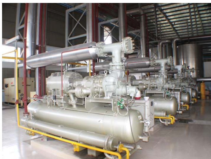
Hệ thống lạnh phân tầng Nhà máy Bia Sài Gòn - Bình Dương
