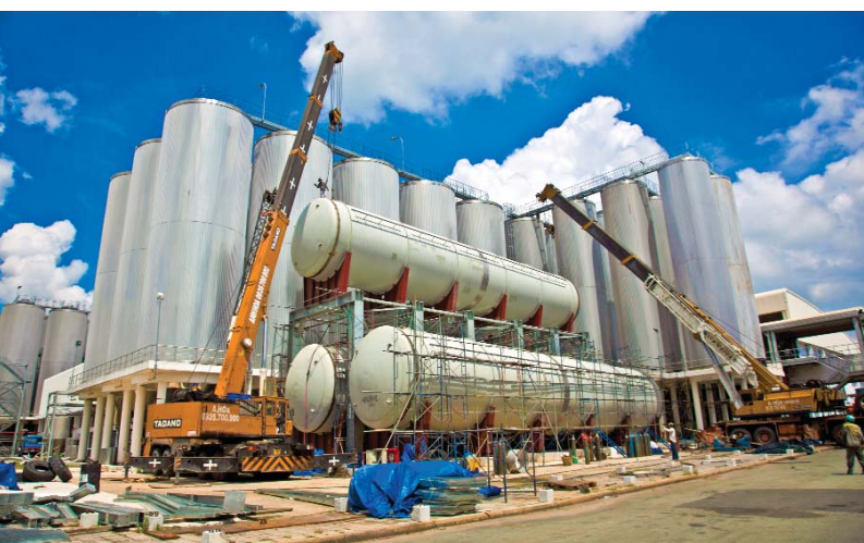
Hệ thống tank lên men đứng và nằm 512 m 3
