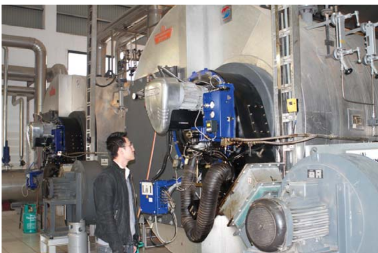
Hệ thống Lò hơi - Nhà máy Bia Sài Gòn - Sông Lam
