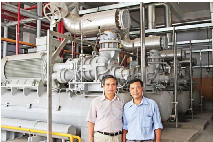
Hệ thống lạnh công suất 6000 kW của Nhà máy Sữa Mega - Vinamilk
