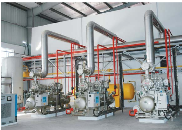
Hệ thống lạnh phân tầng Nhà máy Bia Sài Gòn - Hà Nội
